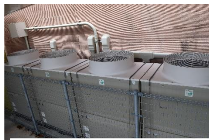
空調機が効かない 能力が足りていない
