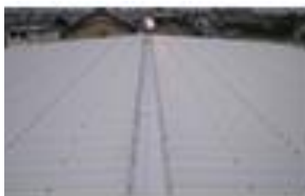
屋根からの 熱流入により暑い
